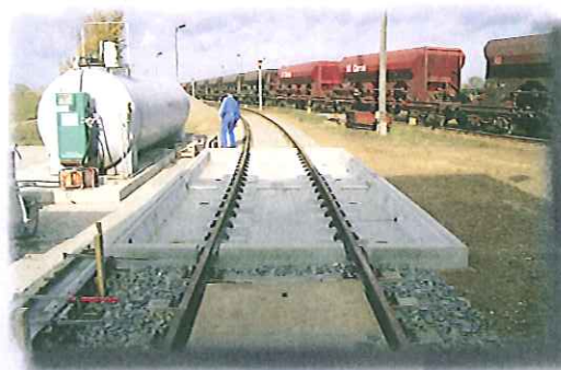
Tankstelle für Schienenfahrzeuge
