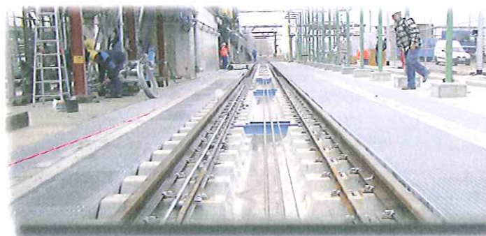
Entladestation mit Seilzug-Rangieranlage
