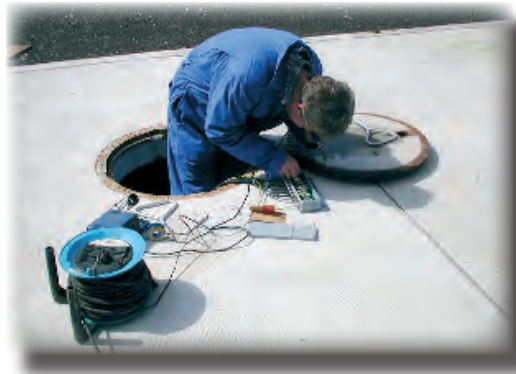
bequemer Zugang für Wartungen
